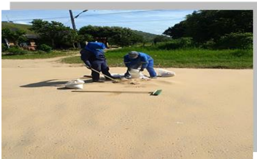
Figura 11. Recolección de arena en vías públicas
