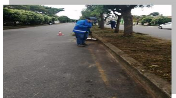
Figura 12. Barrido y limpieza carrera 10.
